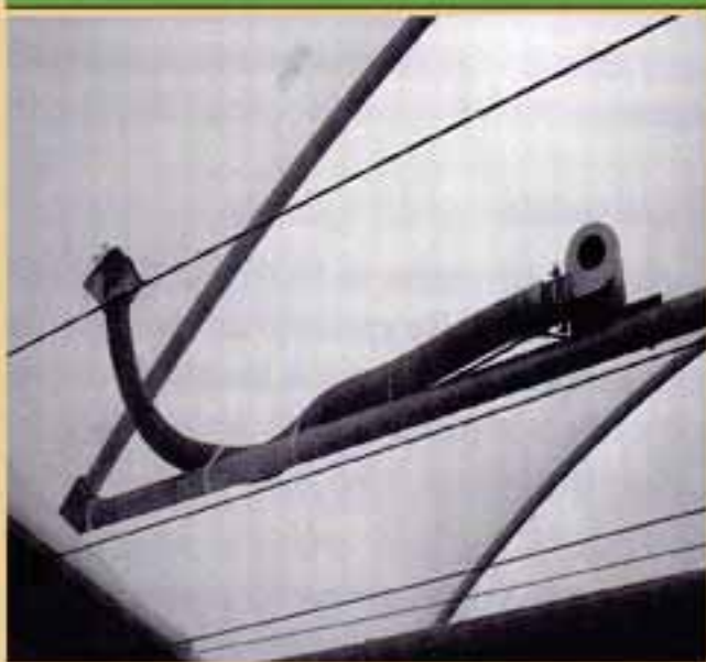
Vista del motor del doble techo inflable (Fuente: PHR)
