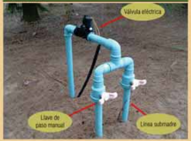
Cañería submadre con válvula eléctrica y dos derivaciones (Fuente: PHR)
